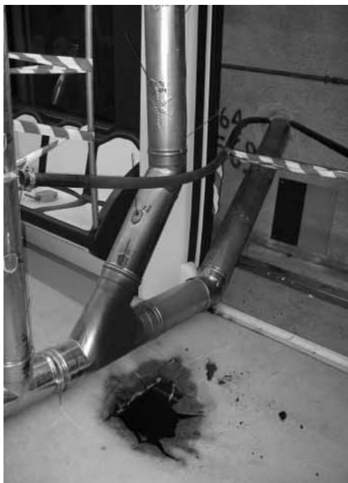
Fig. 5 - Cassa sacrificale dopo il test. Foro sul pavimento
