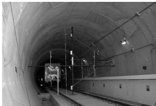
Fig.4 - Montelibretti – Galleria sperimentale strumentata
